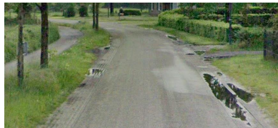
Figuur 9: Boven, het kruispunt Raadhuisstraat – Rootven – Kerkstraat (bron: Cyclomedia) en onder de aanrijdschade van de berm op de Zandstraat (bron: GoogleMaps).
